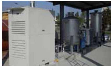
圖3 渦輪式沼氣發電機
