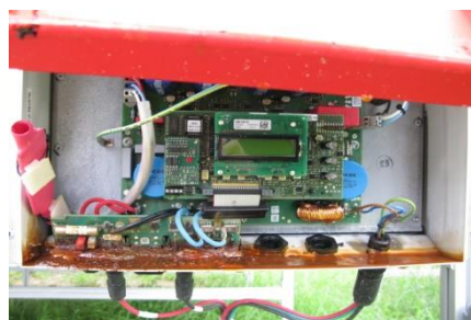
變流器安裝不當，進水 後易造成短路及銹蝕
