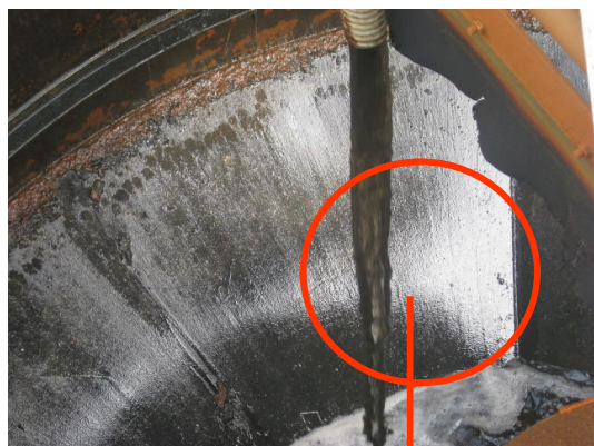
加壓浮除槽表面附著菌垢
