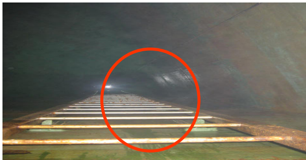
加壓浮除緩衝槽
