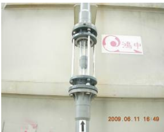
灑水泵浦啟動，確認法蘭及接縫處是否洩漏
