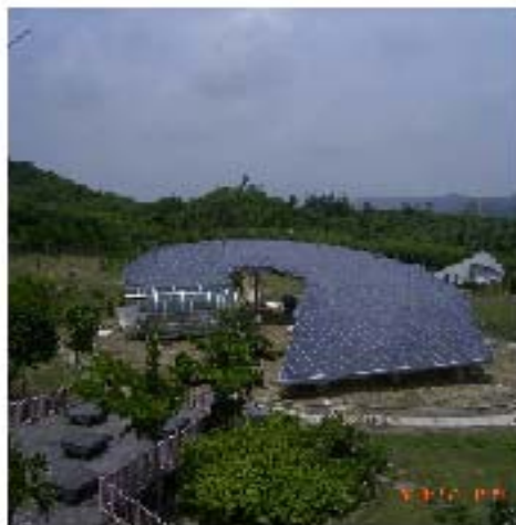
台電公司核三電廠 太陽光電系統(50kW)
