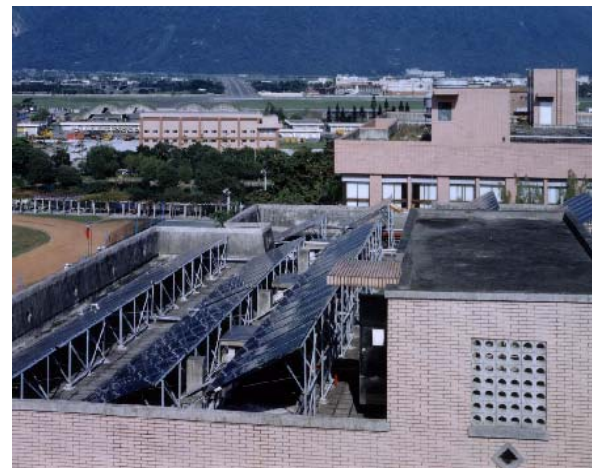
花蓮師範學院太陽能熱水系統 安裝面積：77m 2 (使用人數:115人)
